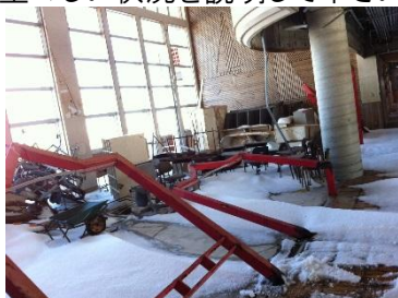
津波で全壊した山元町中浜小
